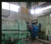
Zastosowanie: Dmuchała powietrza Moc: 18MW, Napięcie: 10.000 V. Klient: Changcheng Yansha Steel Company
