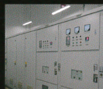
Zastosowanie: Dmuchała powietrza Wysokość 2300 m Moc: 16MW, Napięcie: 10.000 V. Klient: Xining Special Steel Company
