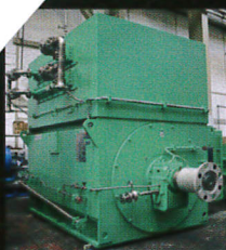
Napęd: pompy odśrodkowe. Silnik indukcyjny przeciwwybuchowy HV. Moc: silnik 5.200kW 4 biegunowy 11.000V Projekt: Shell FPSO, Malezja
